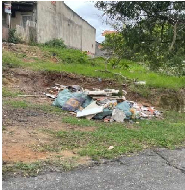
Figura 11- Depósito inadequado de Resíduo da Construção Civil, em um terreno baldio, no Bairro Mancusi, Vassouras, RJ.
