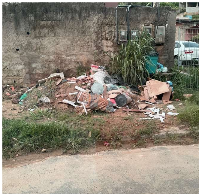
Figura 13 - Depósito inadequado de Resíduo da Construção Civil, em uma calçada, no Bairro Matadouro, Vassouras, RJ.
