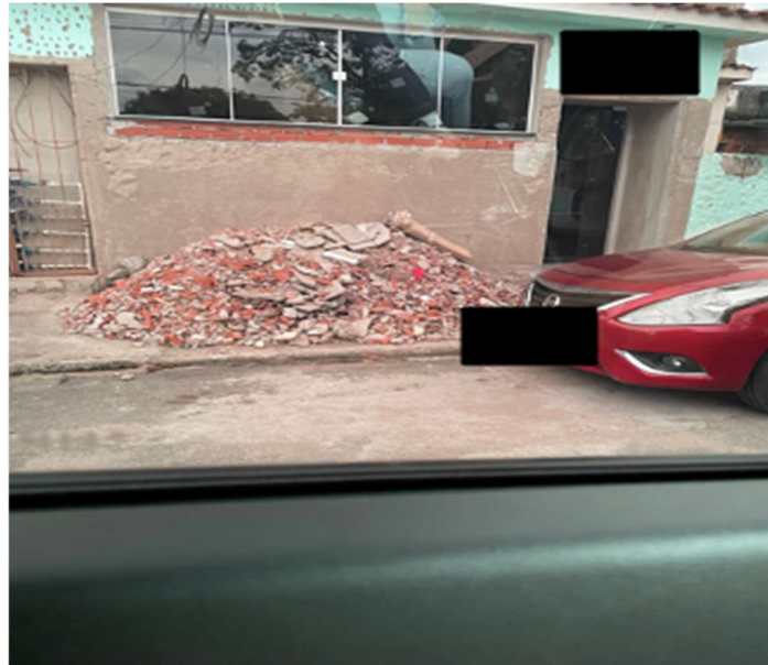
Figura 4: Depósito inadequado de Resíduos da Construção Civil no bairro Alto do Rio Bonito, no município de Vassouras-RJ.
